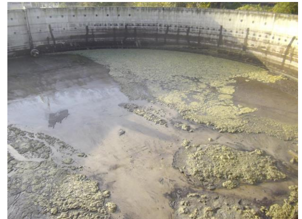
Graisses entraînant des dépôts fermentescibles dans le bassin d'orage de la station
