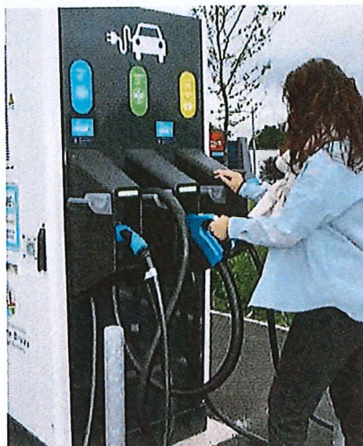
Borne de recharge super rapide installée sur la zone Actipolis à Fouquières-Les-Béthune
